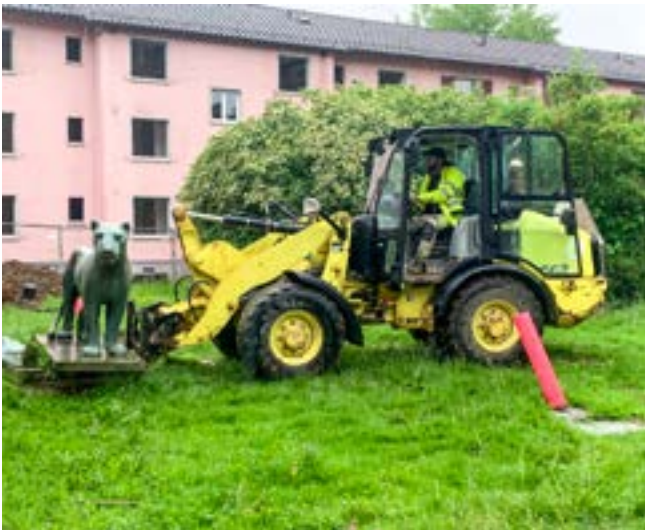
Die Löwin von Arnold Huggler wird am Zwischenstandort vor In Böden 125 mit dem Bagger angehoben.
